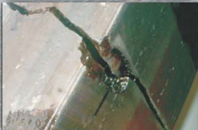
Trinca: fadiga térmica em Aliança de Forno de Cimento A espessura da peça normalmente excede 250mm.
